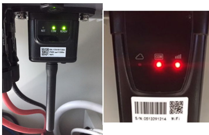
Figura 59 - Stato iniziale dei LED
