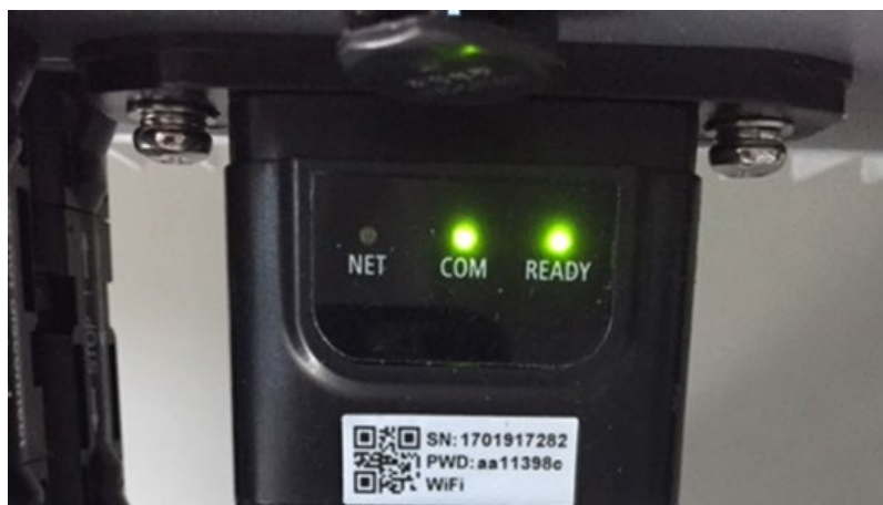
Figura 71 - Stato iniziale dei LED
